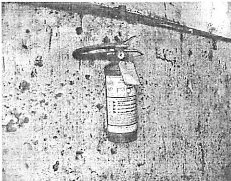
FIGURA 30 – Extintor de incêndio em local de risco.
