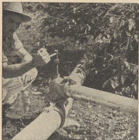
Da tubulação principal partem tubulações secundárias, para formar rede em tóda a lavoura a ser irrigada
