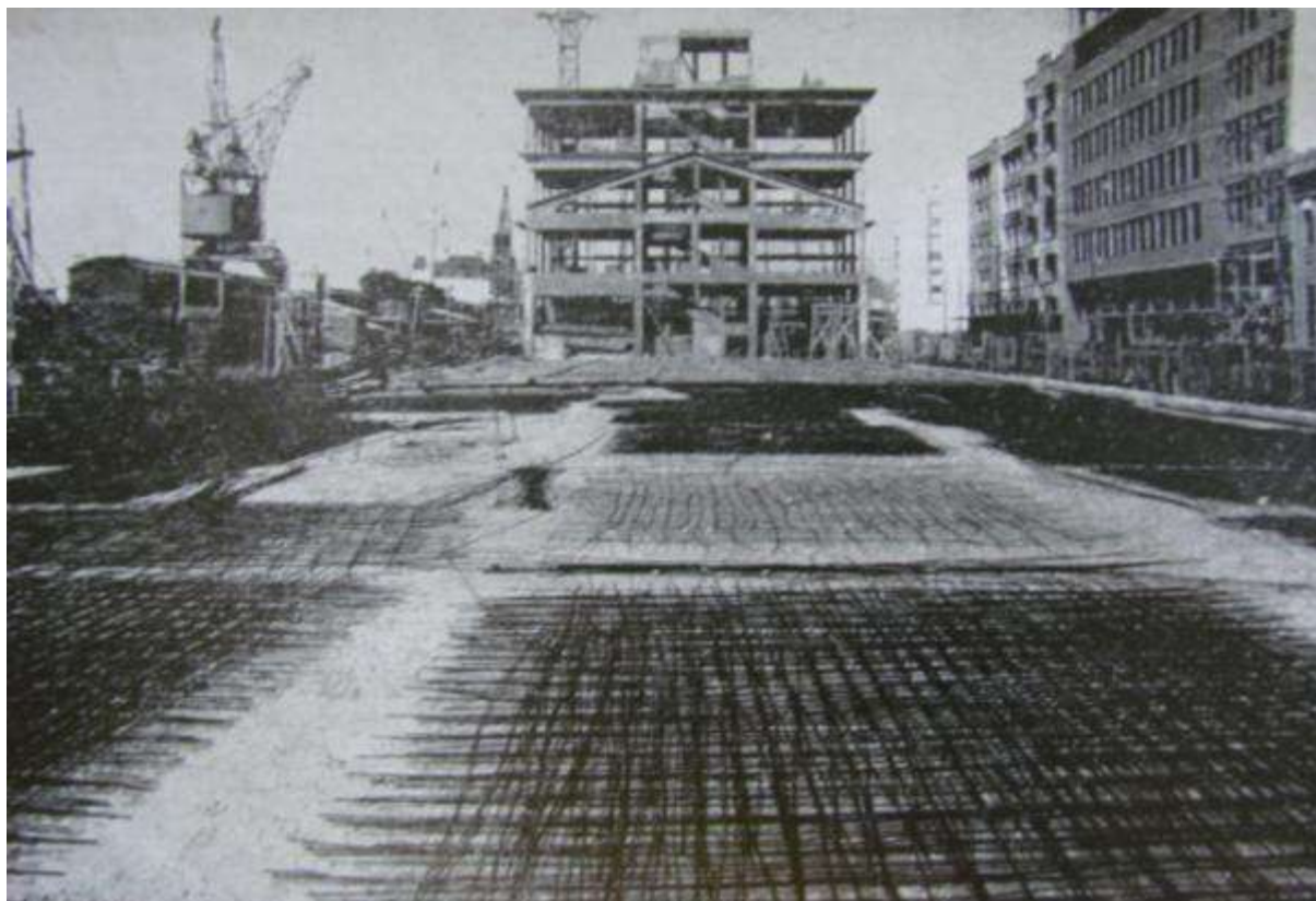
Figura 23: Início das obras de construção do Armazém 4 Fonte: O ESPÍRITO Santo trabalha e confia: 1951-1955. [S.l.:s.n.], 1958.
