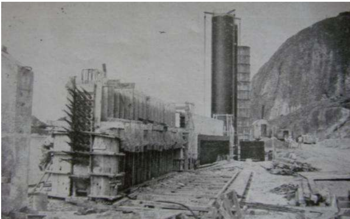
Figura 25: Vistas do canteiro de serviço da Capuaba - construção dos tubulões de concreto para o cais acostável de Paul
