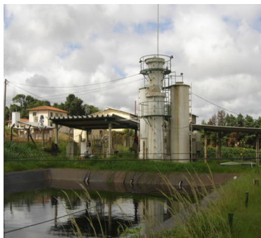
FIGURA 4. Vista parcial do sistema piloto de tratamento da água residuária do café, localizado no NECAF/UFLA.
