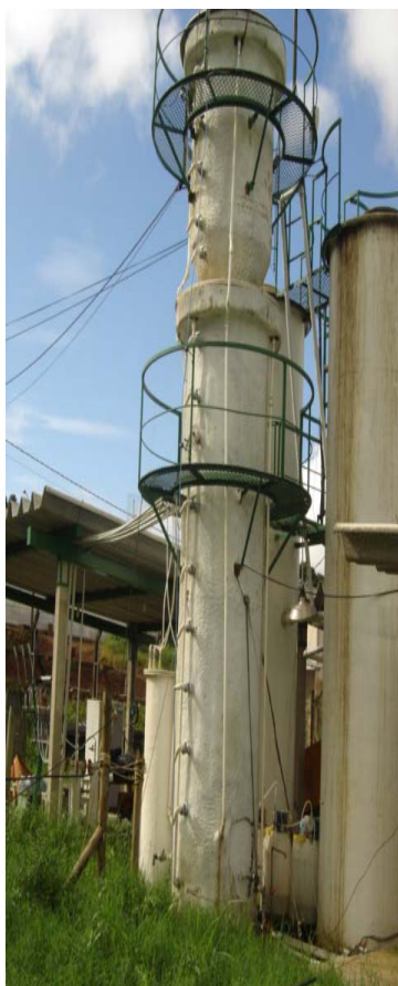
FIGURA 7. UASB concêntrico, constituído por um reator periférico e um reator central, do sistema piloto de tratamento da água residuária do café, localizado no NECAF/UFLA.
