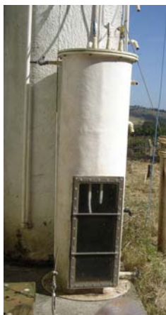
FIGURA 8. Vista parcial do equalizador de pressão do sistema piloto de tratamento da água residuária do café, localizado no NECAF/UFLA.
