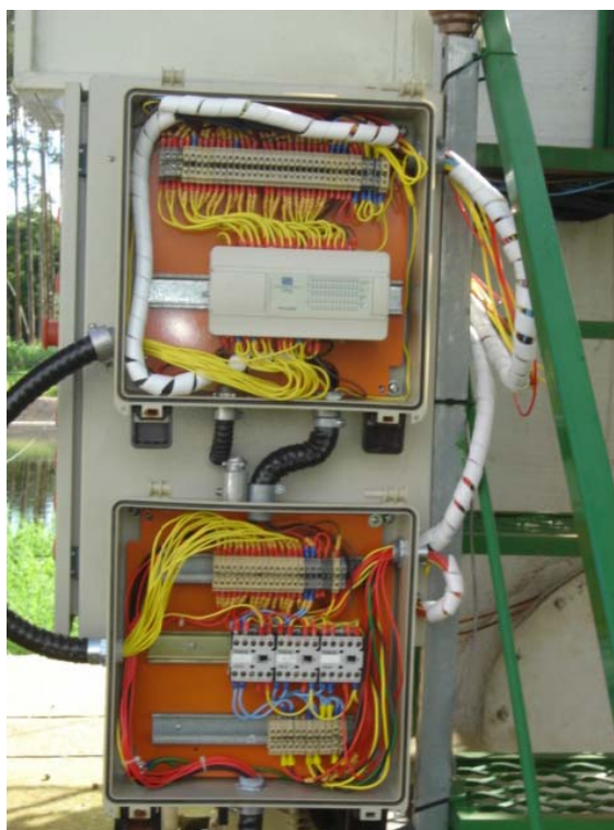
FIGURA 19. Centro de operações do controle lógico programável (CLP), utilizado para monitorar os equipamentos integrantes do sistema piloto de tratamento da água residuária do café, localizado no NECAF/UFLA.
