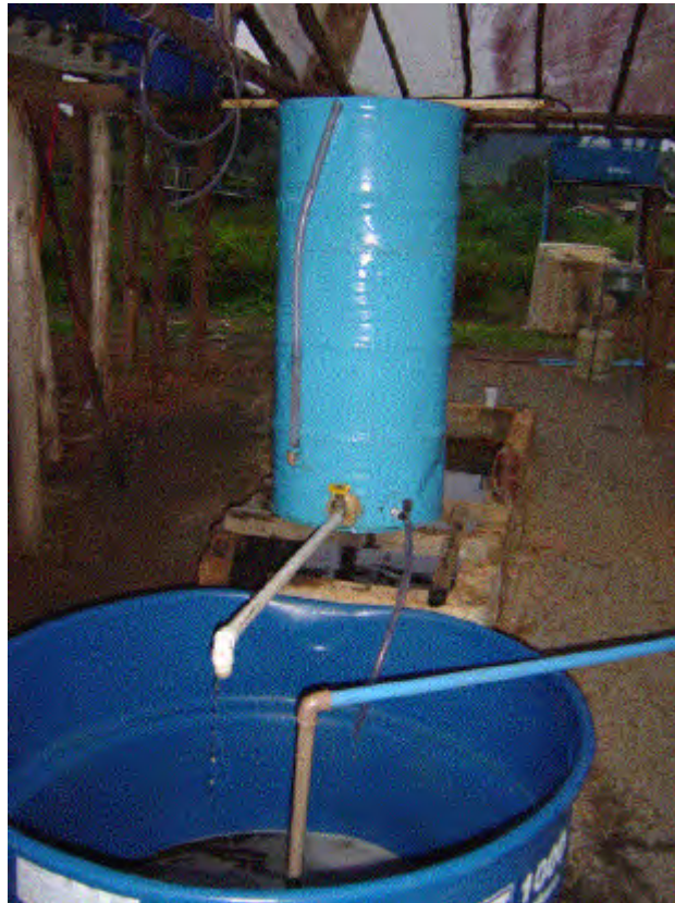
Figura 4 – Vista geral da estrutura utilizada para a filtragem da água residuária.
