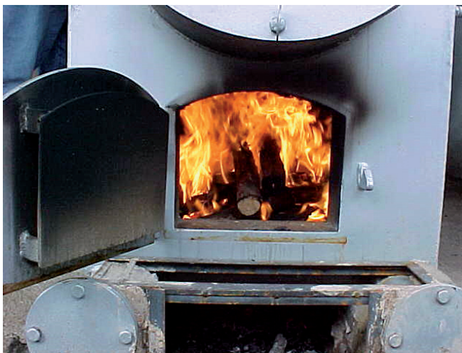
Figura 6. Câmara de combustão da fornalha de uma pequena caldeira.
