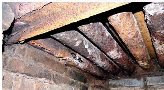
Figura 2. Detalhes de um trocador de calor (ar/ar) seriamente danificado pelo processo de corrosão.
