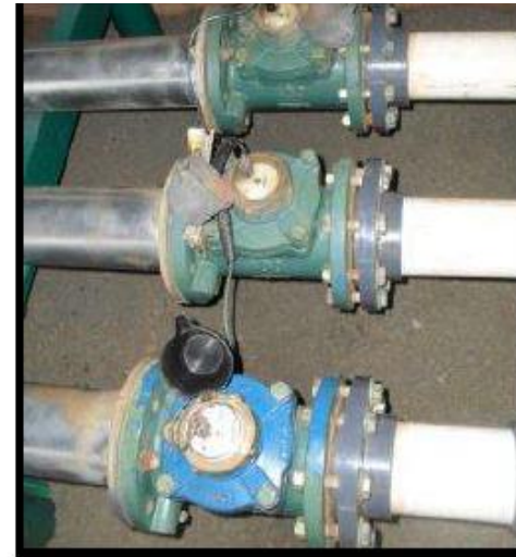
■ Registros de água
