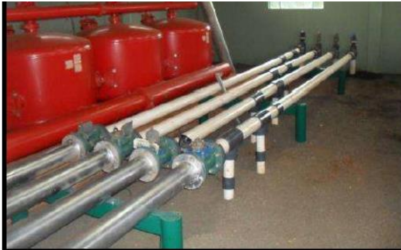
■ Linhas de tubulação
