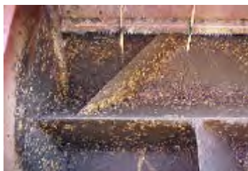
Figura 11 – Duto de distribuição do ar de secagem obstruído.
