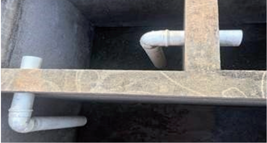
Figura 6. Sistema de limpeza da água do processamento com as caixas de decantação.
