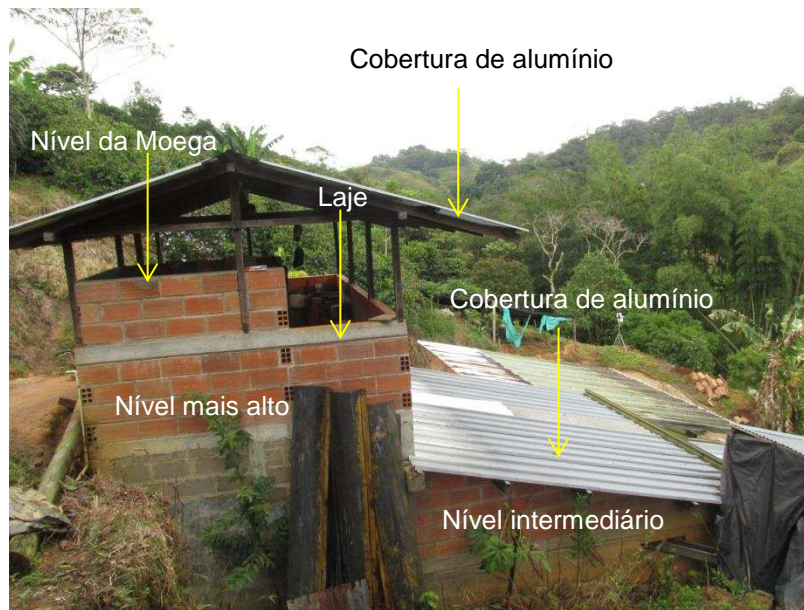
Figura 22 – Coberturas de alumínio na instalação para processamento úmido, no município de San Roque.
