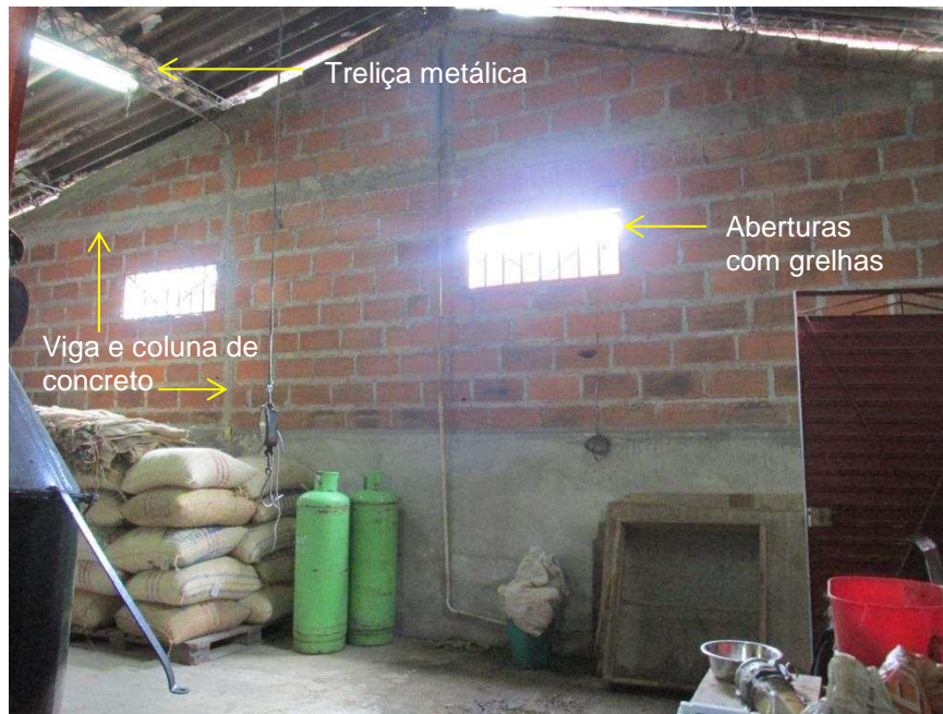
Figura 17 – Interior da instalação para processamento úmido de café, no município de Bello – tipologia 2.
