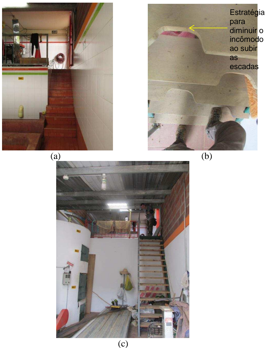
Figura 21 – Escadas de comunicação entre os três níveis da planta baixa da instalação para processamento úmido de café, no município de San Roque – tipologia 3: (a) escadas para descer do nível mais alto ao nível intermediário; (b) e (c) escadas para descer do nível intermediário ao nível mais baixo.
