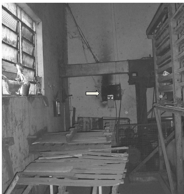
Figura 9 – Painel de comando após incêndio.
