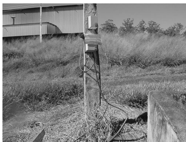
Figura 3 – Painel de comando sem proteção.
