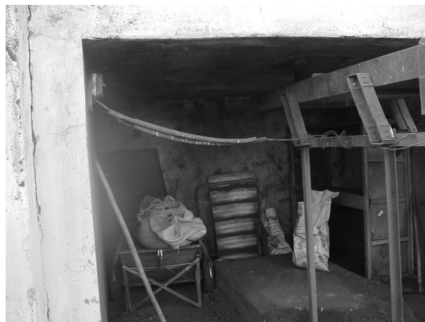
Figura 2 – Fiação exposta e sem proteção.
