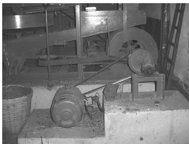
Figura 16 – Polias sem proteção e local sujo.
