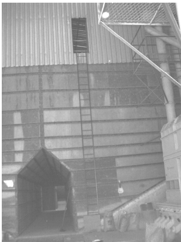
Figura 10 – Escada com mais de 2,00 metros de altura.
