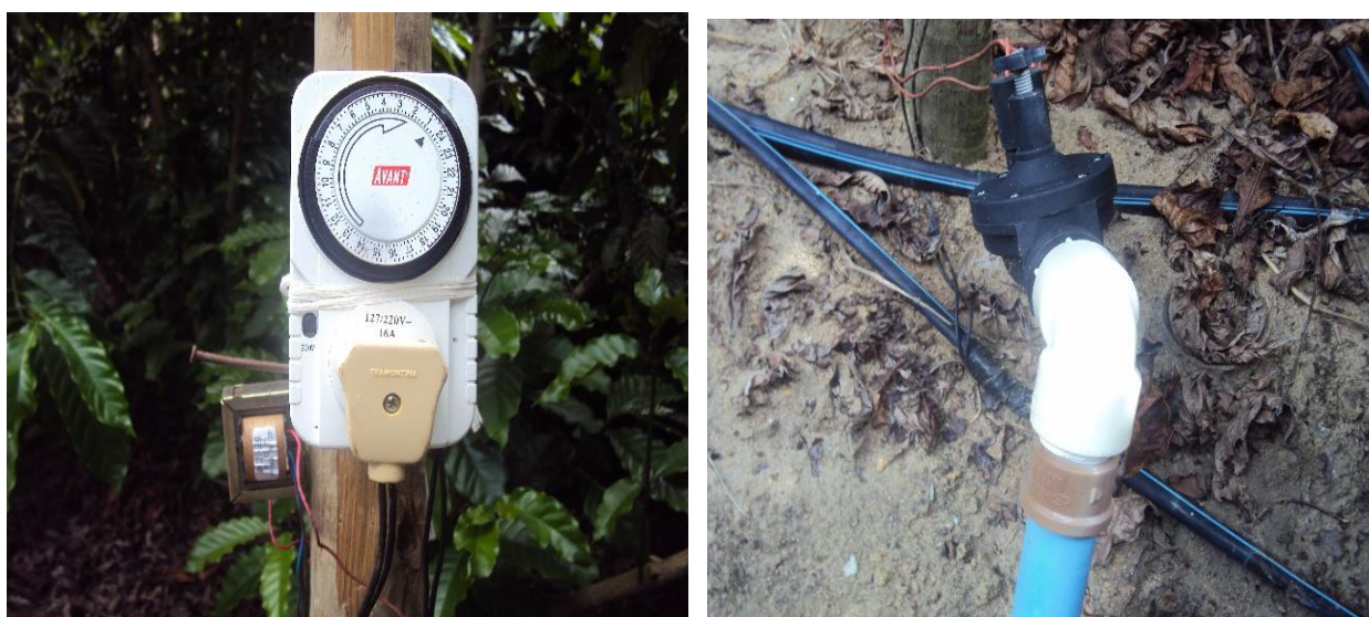
Figura 2A. Timer e válvula solenoide instaladas no início de cada parcela para controle do tempo de irrigação.
